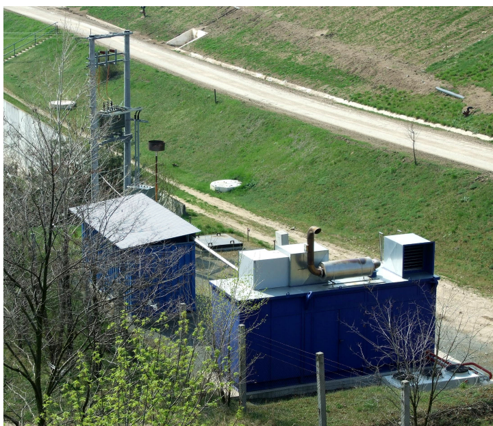
Obrázek 40: Kogenerační jednotka a transformátor na skládce v Žabčicích
